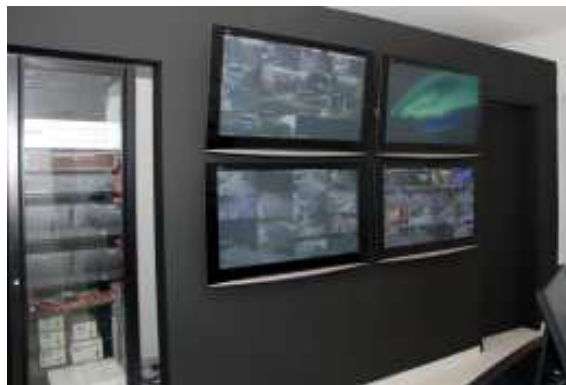
Quatro grandes monitores, de 42 polegadas, permitem visualizar todas as câmeras do sistema de monitoramento
